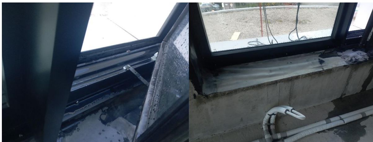
Obrázok 8 – prienik vody cez funkčnú škáru JV okna, krídlo okna (vľavo), parapet okna(vpravo)
