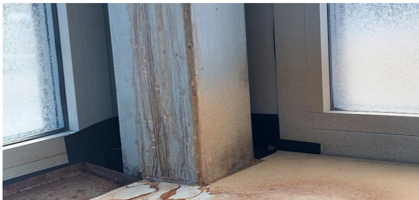
Obrázek 3 – dodatečné opravy v místě vytékání kondenzátu ze souvrství
