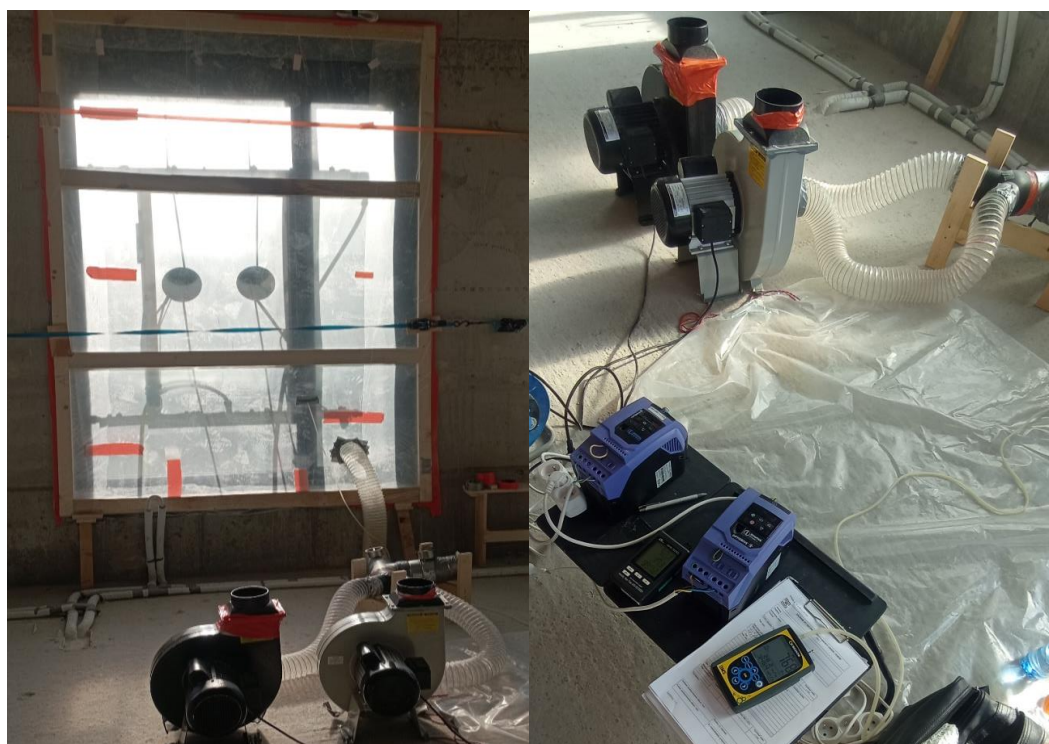
Obrázok 6 – Podtlak vzduchu z interiéru, tlaková komora a radiálne ventilátory (vľavo), reguláry napätia a diferenciálny tlakoměr CRESSTO
