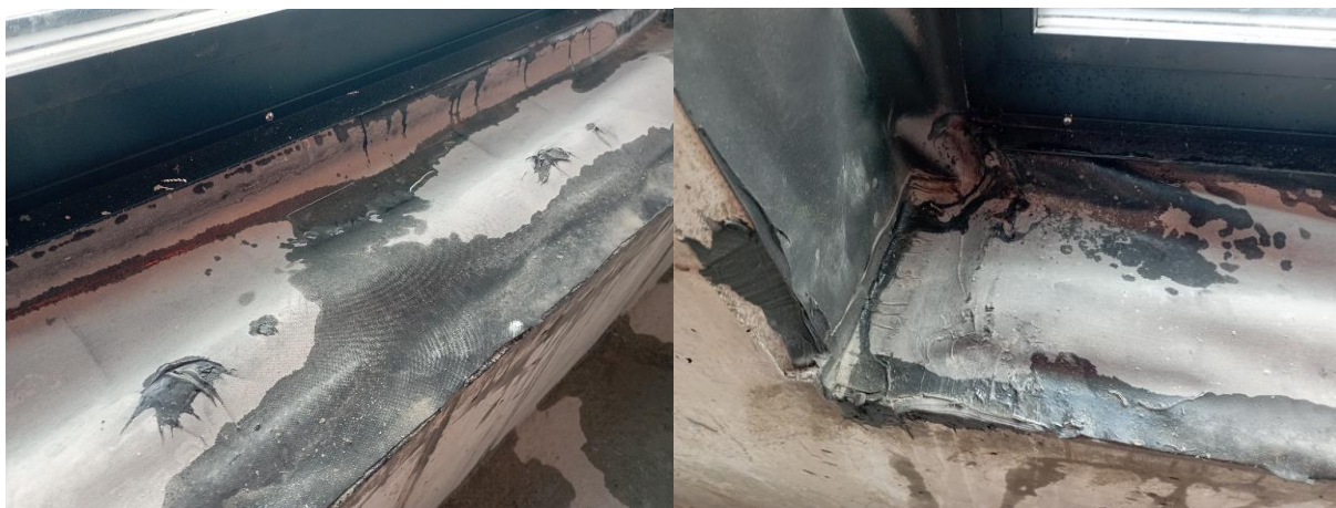
Obrázok 7 – Prienik vody cez funkčnú a pripojovaciu škáru SV okna, parapet pred pevnou časťou okna (vľavo), roh pevnej časti okna(vpravo)
