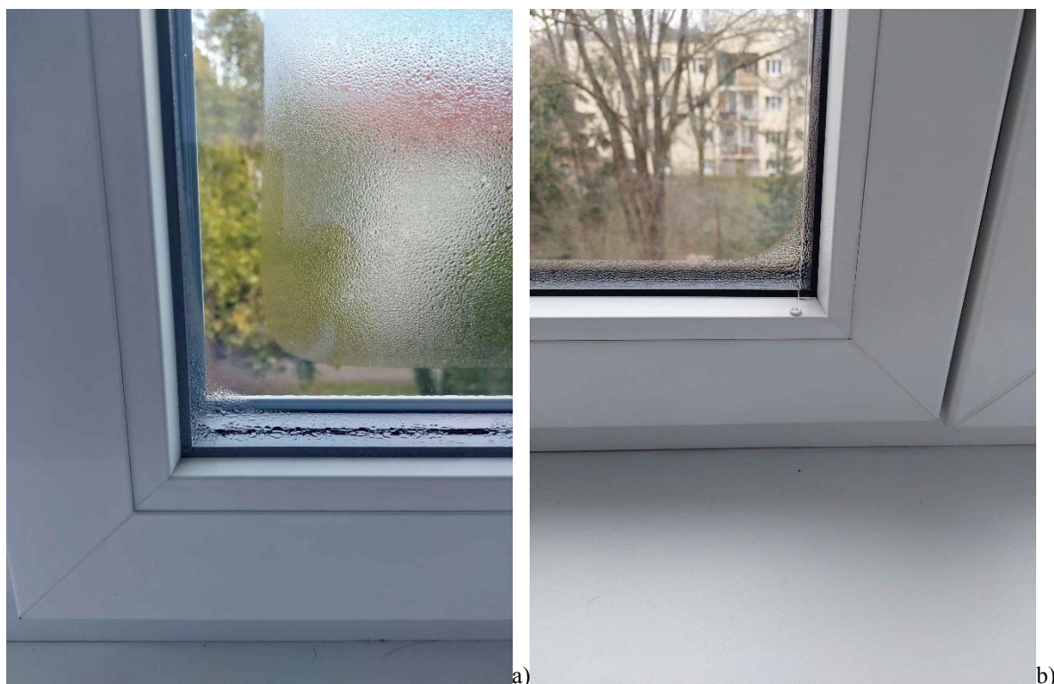
Obrázok 1 – Výskyt povrchovej kondenzácie na a) trojskle (teplý rámik, orientácia sever, kompozitný profil okna); b) dvojskle (teplý rámik; orientácia juh, starší profil okna) v jesenných mesiacoch počas jednej noci
