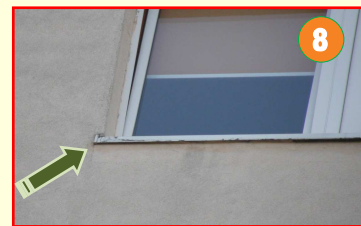
nedostatočné vyloženie parapetného plechu
