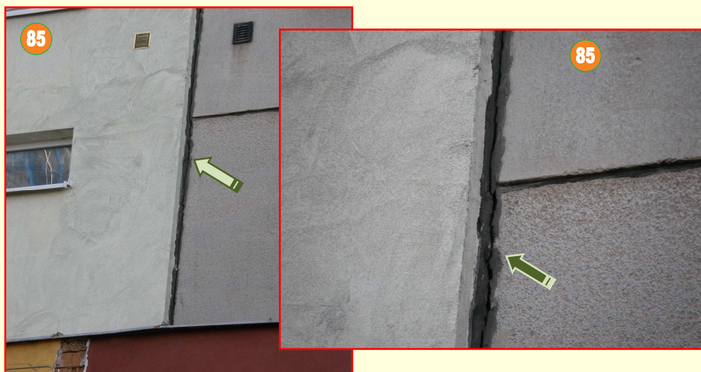
nekvalitne prevedený detail pri dilatácii medzi bytovými domami
