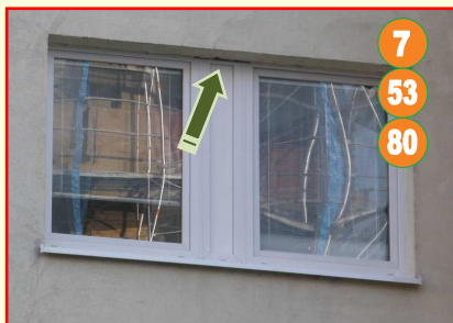
pohľad na plastové okno, nedotmelené nadpražie
