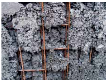
Obr. 5 Príklad chyby betónovej konštrukcie v dôsledku nedokonalého vyplnenia debnenia betónom
