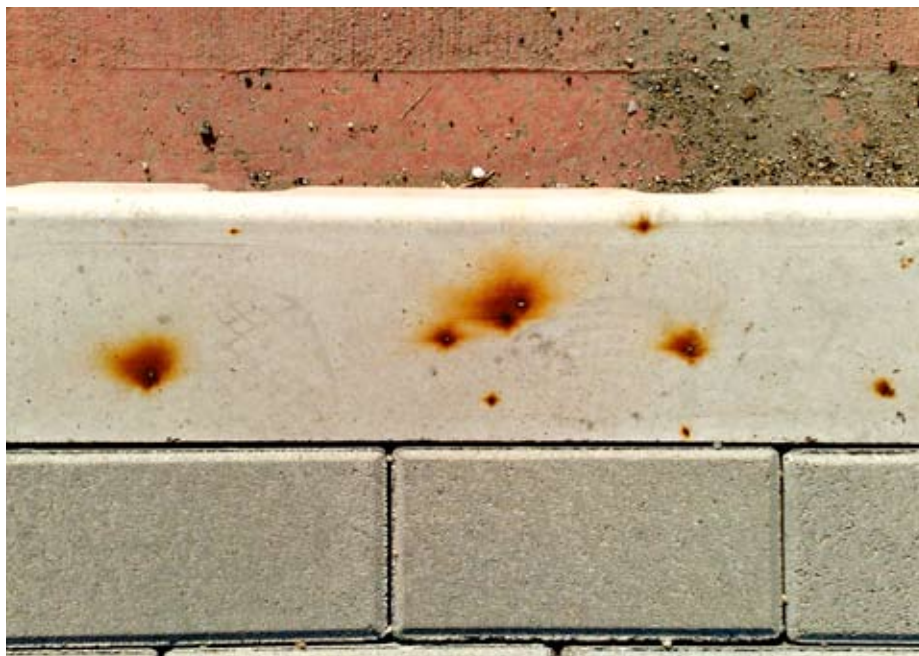
Obr. 13: Stopy korózie ocelových vlákien na cestnom obrubníku
