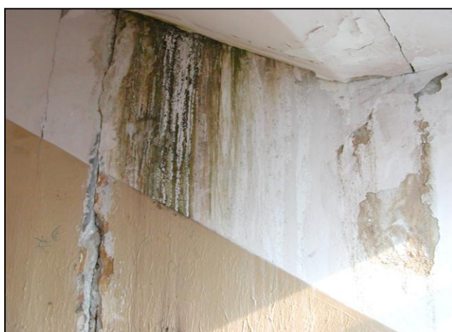
▼ Záteky do schodišťa cez porušené styky panelov Leakage in staircase via disrupted panel joints
