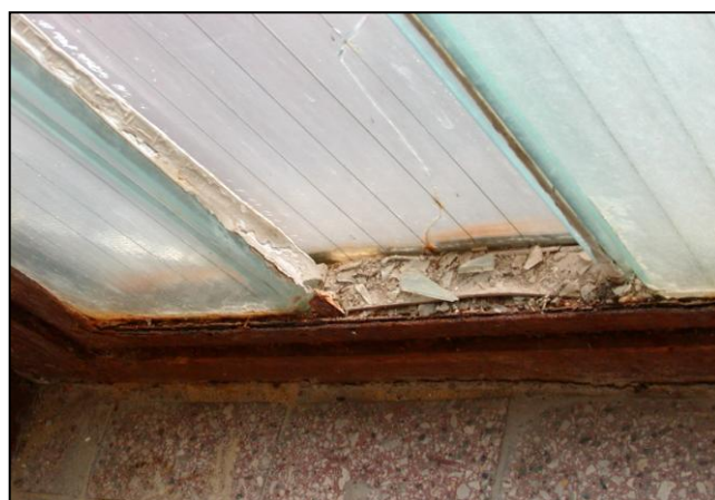
▼ Poruchy Copilitovej steny Faults of Copilit wall
