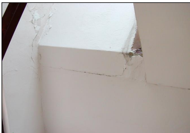
▼ Následky vzájomných posunov schodišťového ramena a podesty Impact of mutual shifts in the staircase arm and landing
