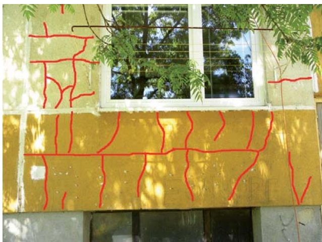
Obr. 3 Sieť trhlin v OPP bytového domu T 06 B v Nitre
