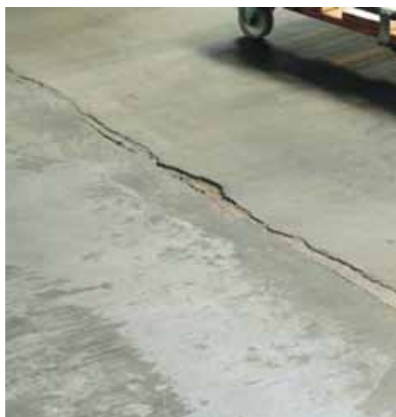
Obr. 13: Poškodenie pracovnej škáry
