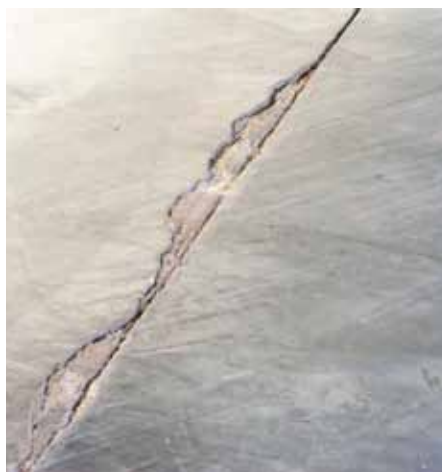
Obr. 14: Poškodenie kontrakčnej škáry
