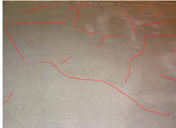
Obr. 8: Kontrakčné zmršťovacie trhliny
