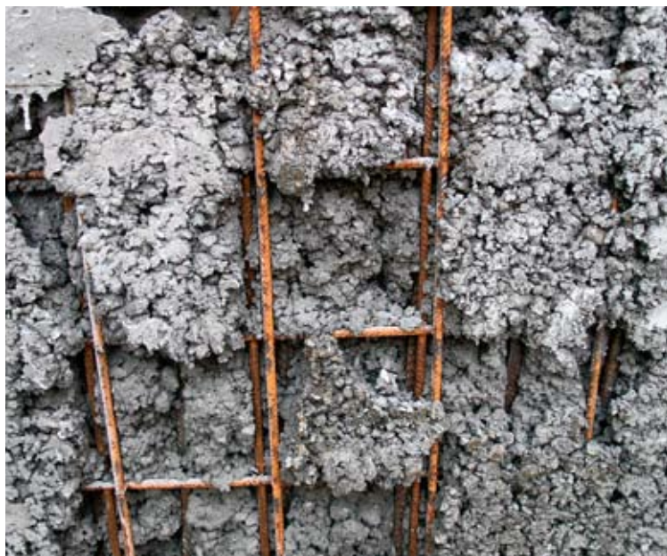
Obr. 6: Príklad vady betónovej konštrukcie v dôsledku nedokonalého vyplnenia debnenia betónom
