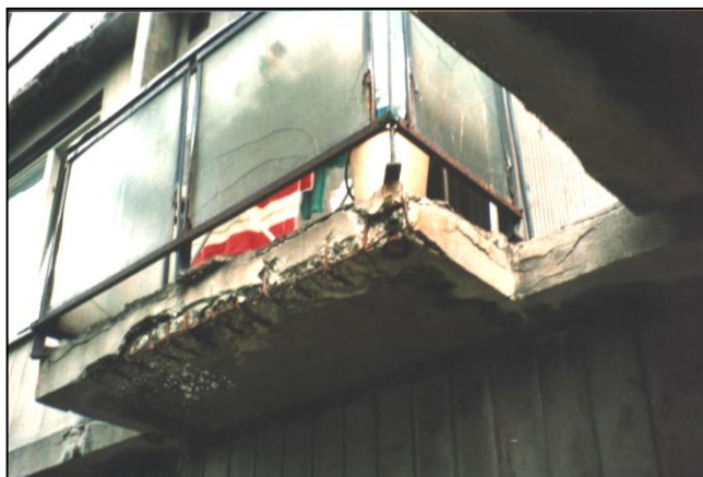
Pohľad na zdegradovaný železobetónový balkón LB realizovaný na 1. NP; rozsiahla korózia konštrukcie zábradlia, popraskaná výplň zábradlia View to the degraded steel-concrete balcony LB realised at the first storey; the large corrosion of a balcony railing; a cracked filling of rail
